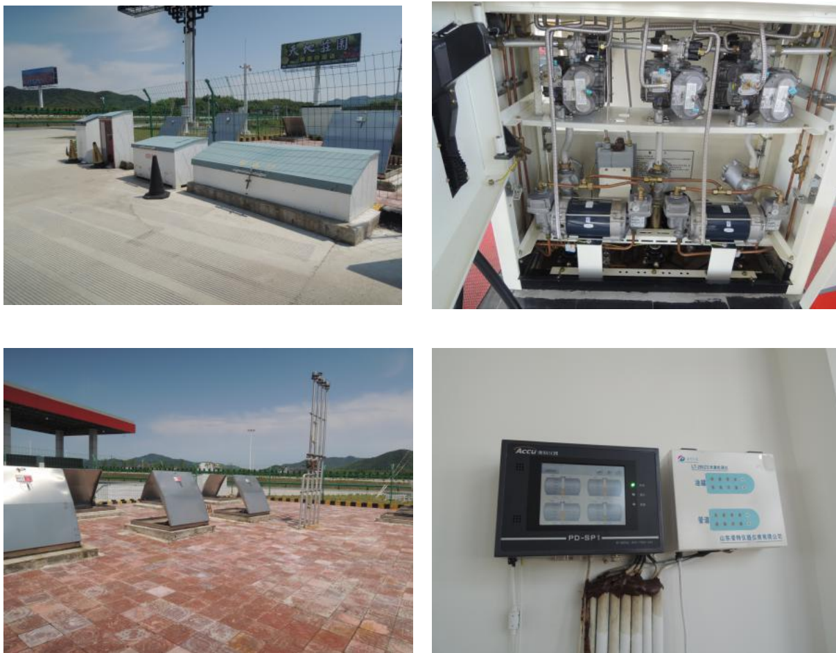
图 9-2 油气回收系统现场情况
