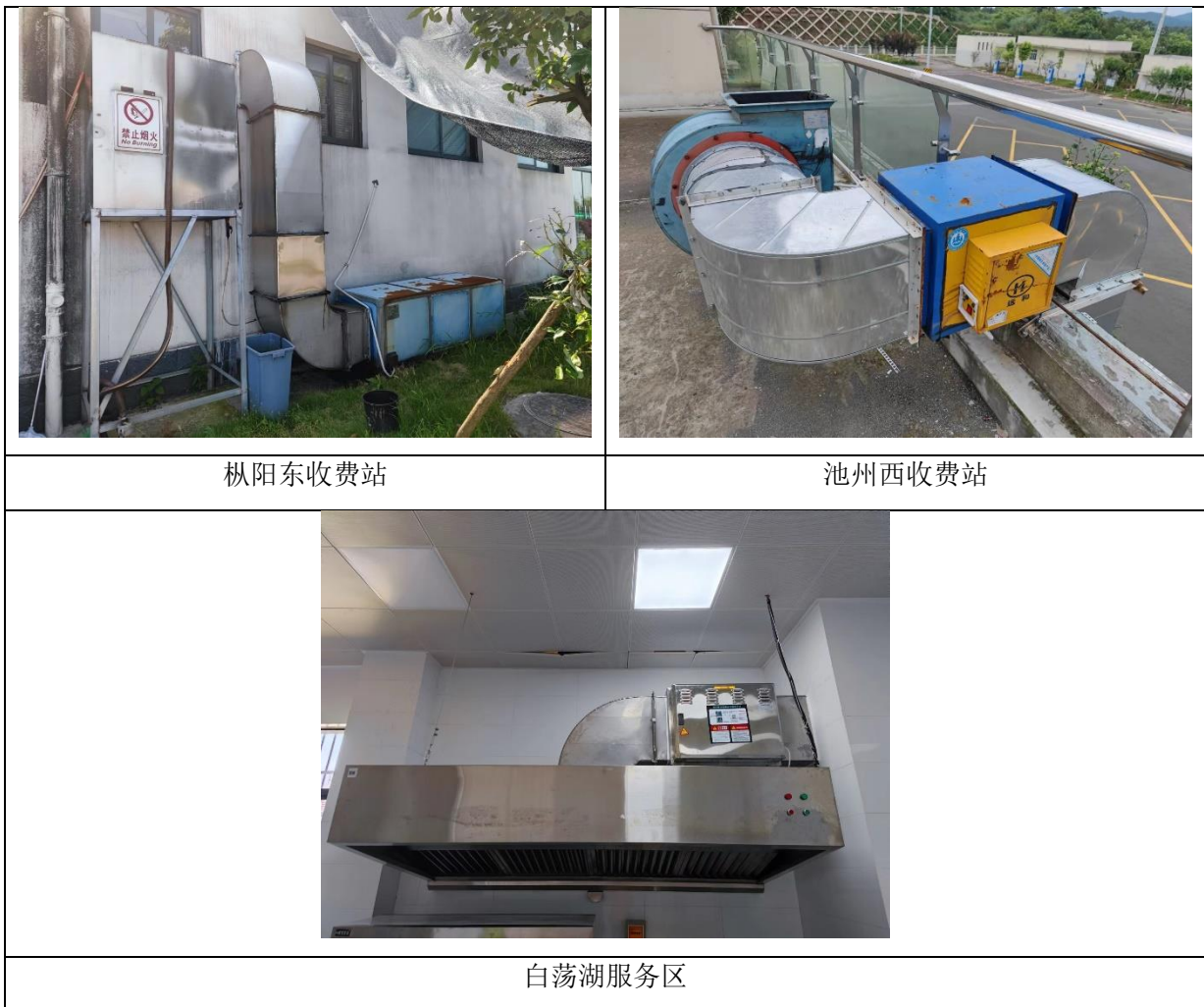
图 7.2-1 沿线附属设施食堂油烟净化器
