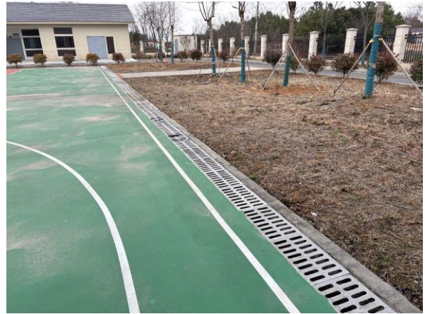
沿线设施区排水
